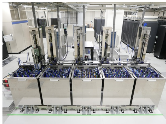
図 1 「ExaScaler-1.4」液浸槽 5 台による液浸冷却スーパーコンピュータ「Shoubu（菖蒲）」
